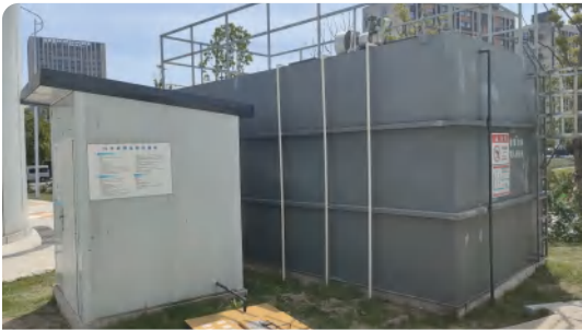
临时污水处理设施
