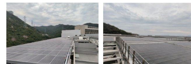
B区楼顶光伏
